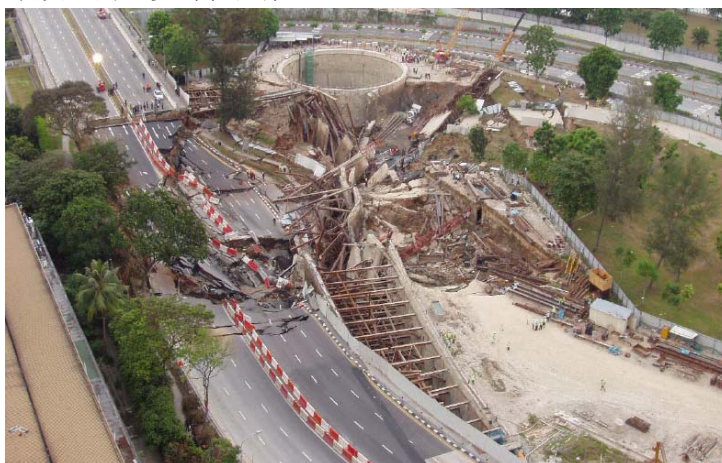
图 30-1 新加坡地铁基坑坍塌现场图
